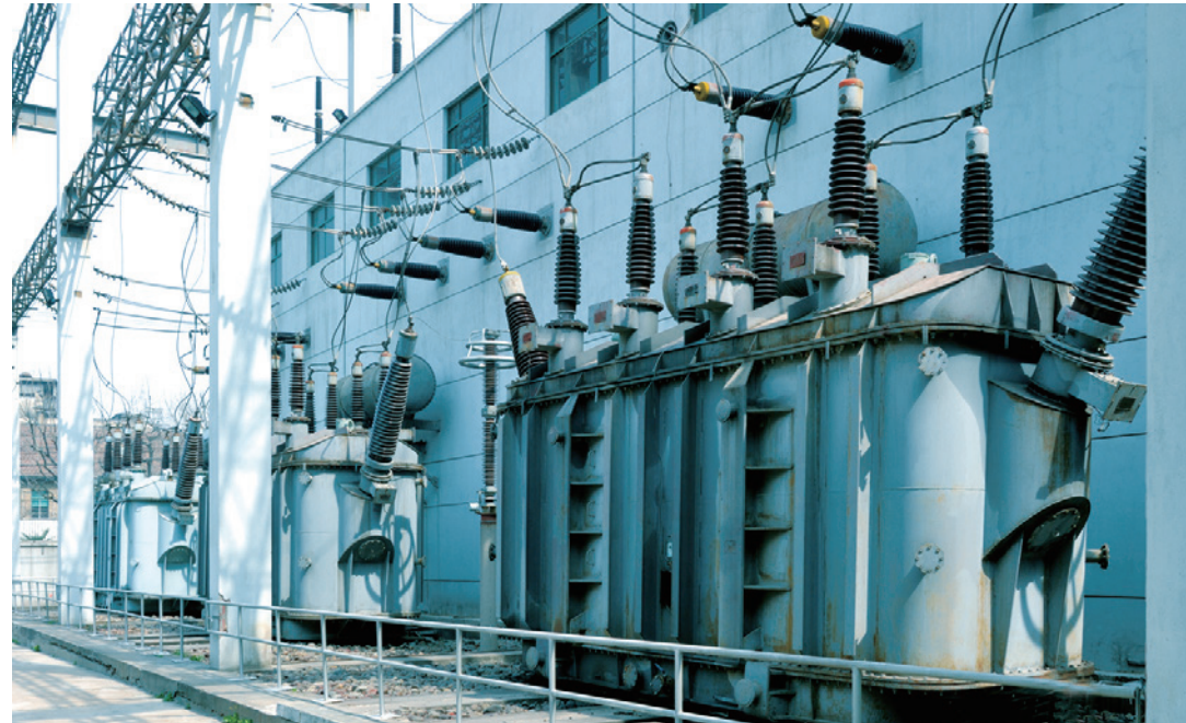
220kV/60MVA (1500MVA) 冲击试验变压器组 220kV/60MVA (1500MVA) Impact Testing Transformer Bank
