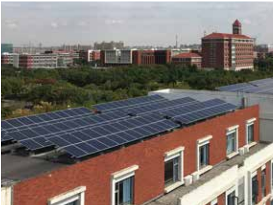
上海某高校实验楼190kW光伏项目
