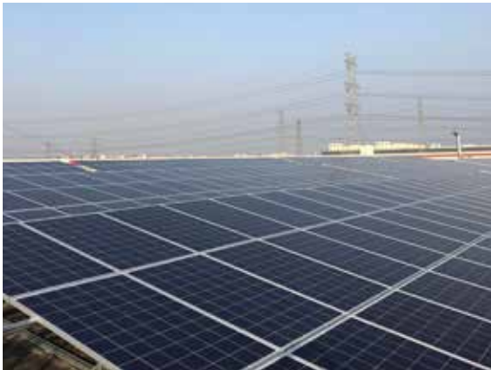
奉贤申通300kW光伏项目
