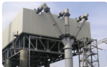
内蒙古汇能煤化工煤制天然气项目II
