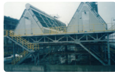
中石化镇海炼化透平空冷
