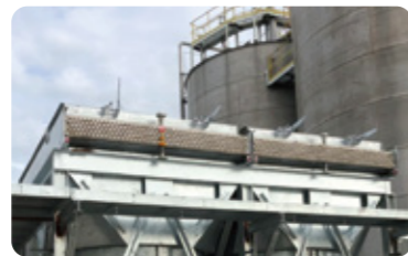
加纳ANOKYA加压站高压空冷器
