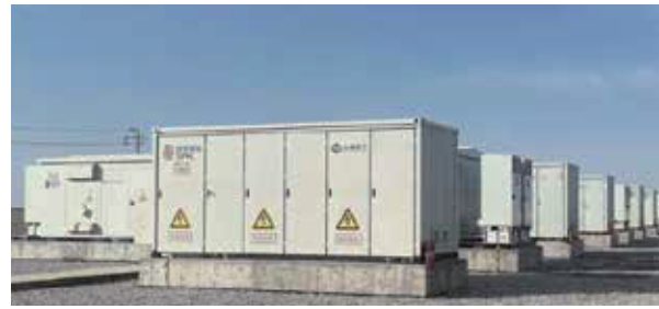
15MW/45MWh 新疆柯坪光伏配储项目
