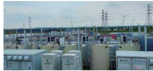
10MW/20MWh 灌云全钒液流储能示范项目
