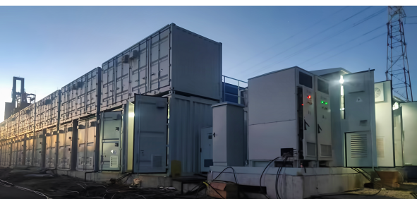
12MW/48MWh 上海吴泾电厂项目
