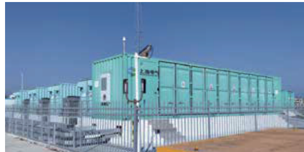
2MW/2MWh 汕头智慧能源示范项目
