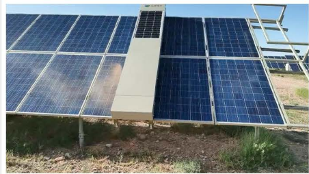
应用项目 甘肃 100MW 地面电站
