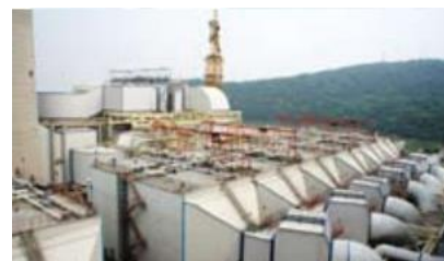
浙能嘉华电厂 (中国首套低低温电除尘改造项目)
