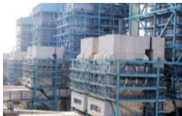
福建嵩屿电厂 (中国首套脱硝设备)
